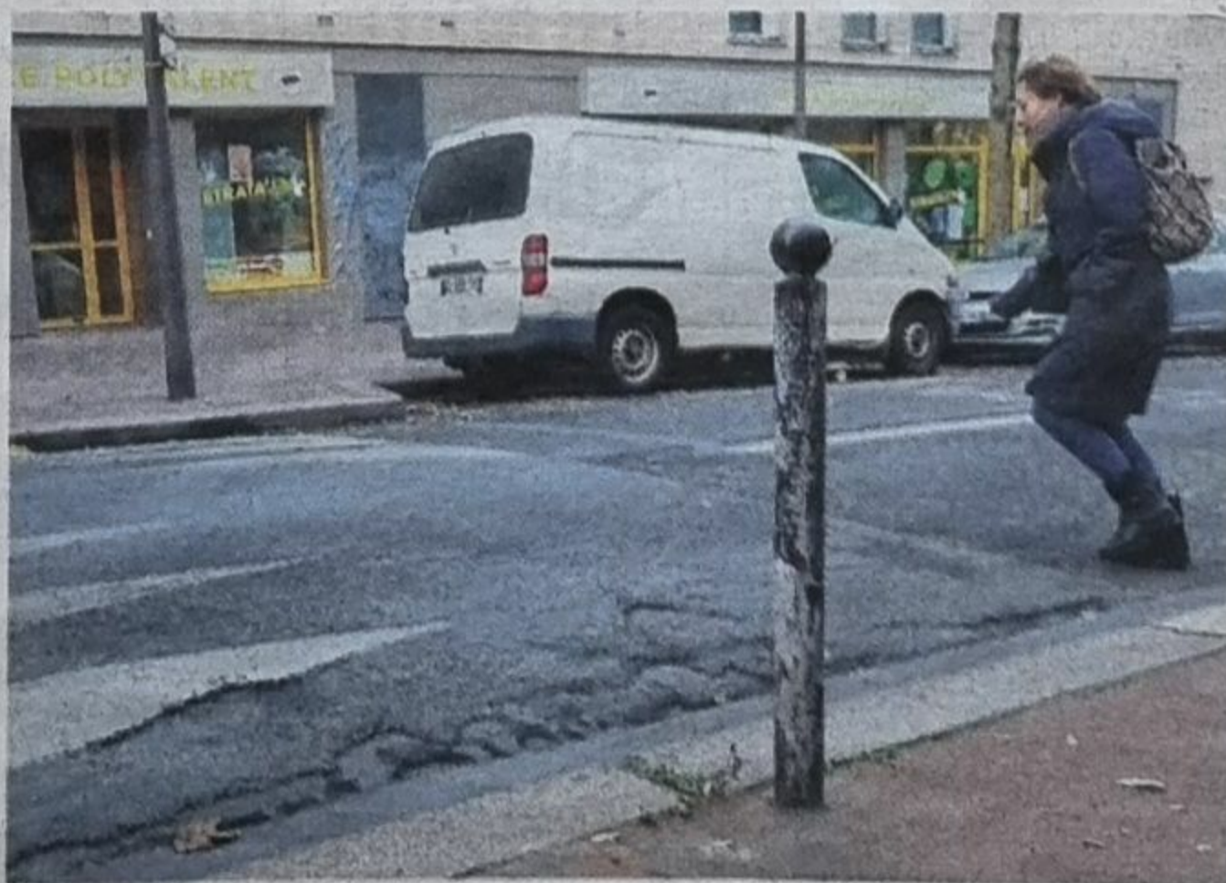
Rue des Couronnes (Paris XX e ). Des nids-de-poule se sont formés le long de l'aménagement, rendant son franchissement plus dangereux.
